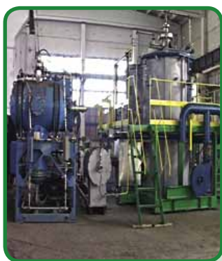
Действующая установка по переработке природного газа в синтез-газ производительностью 100 куб. м/час.
